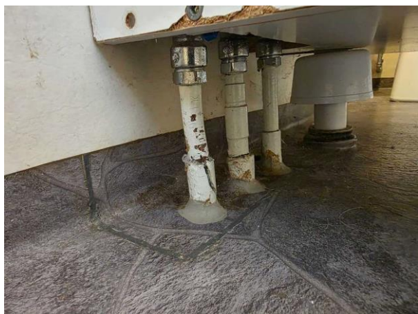
Bild 23: - Invändigt, Entréplan, badrum Otäta rörgenomföringar i våtzon 1, golv.
