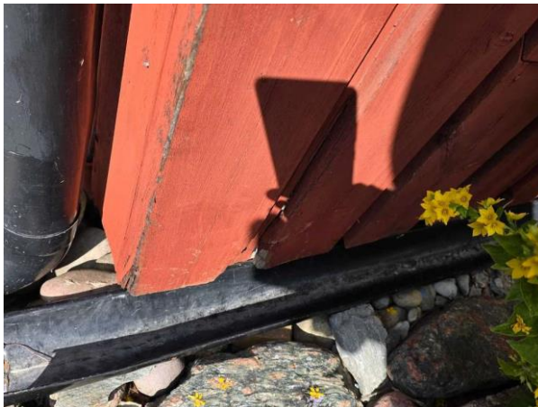
Bild 4: Utvändigt, Fasad, Fasad blek med torrsprickor och mindre rötskador på nedre delar av fasad.
