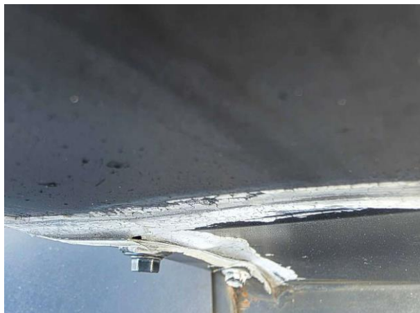
Bild 13: - Utvändigt, Yttertak, Otätheter vid takgenomföringar.
