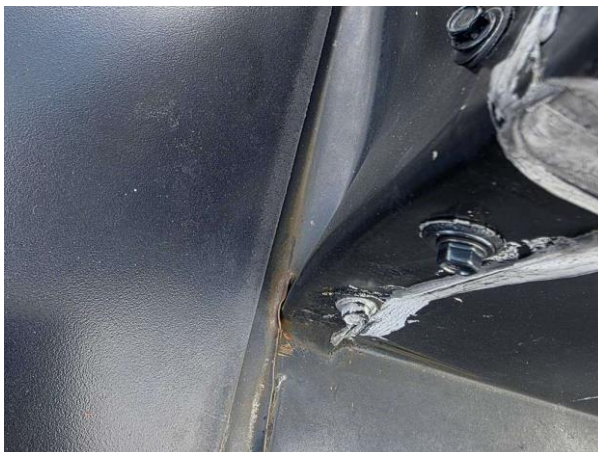
Bild 14: - Utvändigt, Yttertak, Otätheter vid takgenomföringar.
