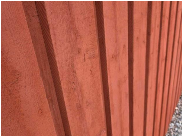
Bild 3: Utvändigt, Fasad, Fasad blek med torrsprickor och mindre rötskador på nedre delar av fasad.
