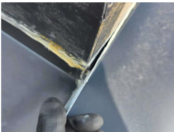
Bild 16: - Utvändigt, Yttertak, Otätheter vid takgenomföringar.
