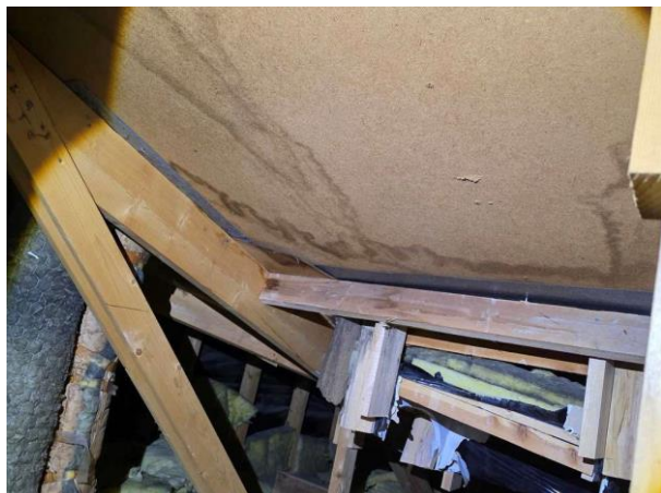
Bild 7: Utvändigt, Vind, Fuktmärken med påväxt på undertak
