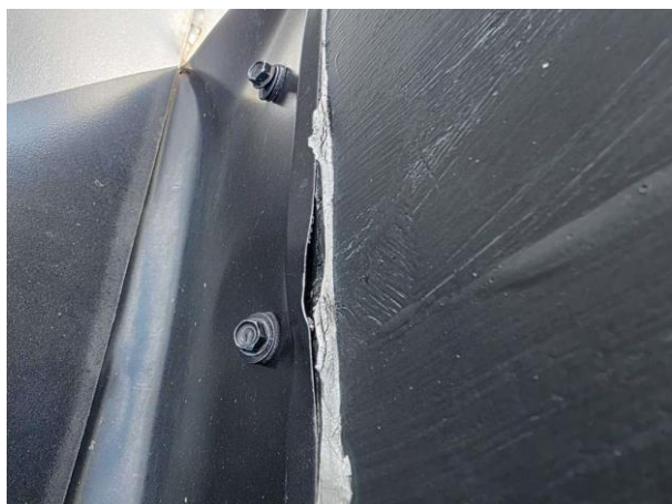
Bild 15: - Utvändigt, Yttertak, Otätheter vid takgenomföringar.
