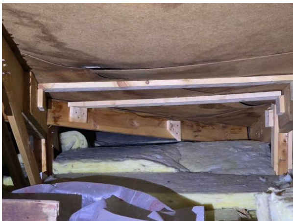
Bild 8: Utvändigt, Vind, Fuktmärken med påväxt på undertak
