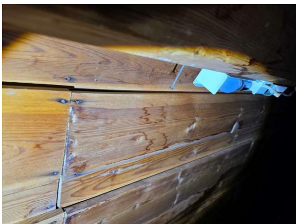
Bild 22: - Invändigt, Övervåning, Fuktmärken på undertak runt skorsten. Spricka i vägg. Inga förhöjda fuktvärden uppmättes vid besöket...
