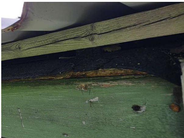
Bild 13: Utvändigt, Yttertak, Den tekniska livslängden på yttertaget har passerats och är i behov av byte/renovering.
