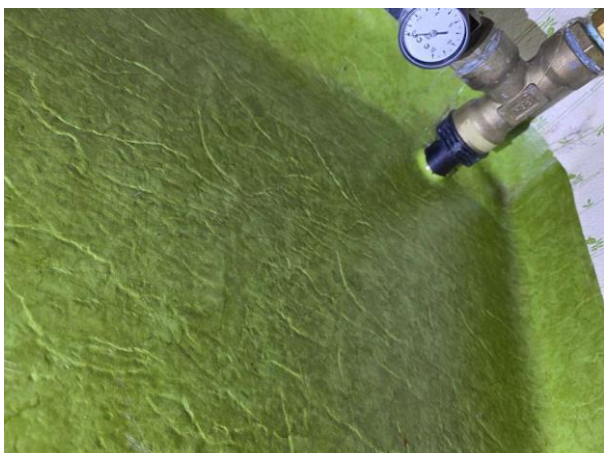
Bild 15: - Invändigt, Entréplan, äldre tät och ytskickt där den tekniska livslängden har passerats. Otäta rör genomföringar i våt...
