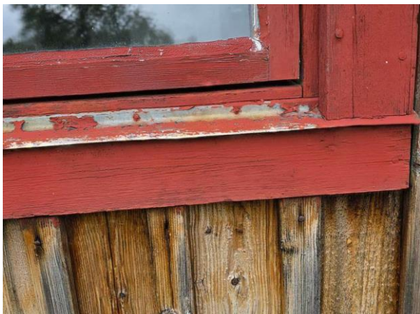
Bild 7: Utvändigt, Fönster, Kittskador och färgsläpp noterades på fasad.
