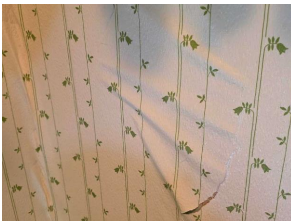
Bild 16: - Invändigt, Entréplan, äldre tät och ytskickt där den tekniska livslängden har passerats. Otäta rör genomföringar i våt...
