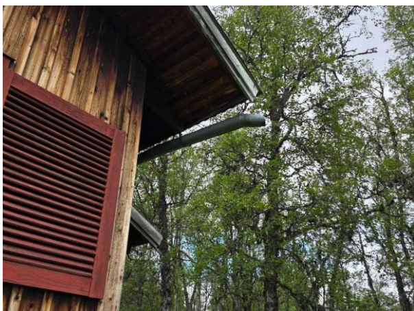
Bild 11: - Utvändigt, Avvattning, Dagvatten leds ej bort från grund. Hängrännor/stuprör saknas/skadad efter troligt snöras.
