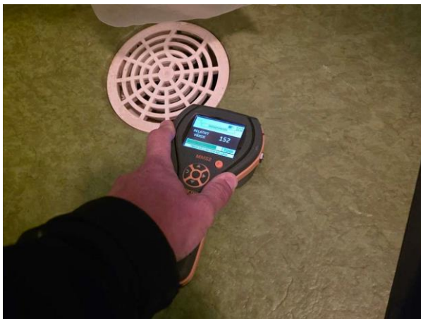
Bild 14: - Invändigt, Entréplan, äldre tät och ytskickt där den tekniska livslängden har passerats. Otäta rör genomföringar i våt...
