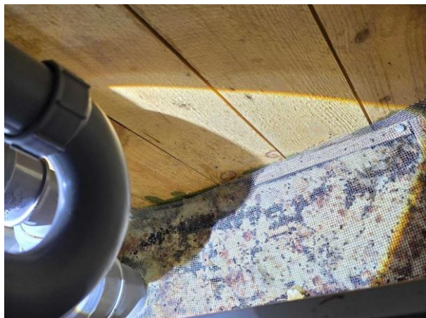
Bild 19: Invändigt, Entréplan, Otäta rörgenomföringar i diskbänkskåp med stora mängder musspillning.
