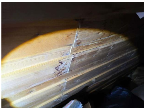
Bild 21: - Invändigt, Övervåning, Fuktmärken på undertak runt skorsten. Spricka i vägg. Inga förhöjda fuktvärden uppmättes vid besöket...
