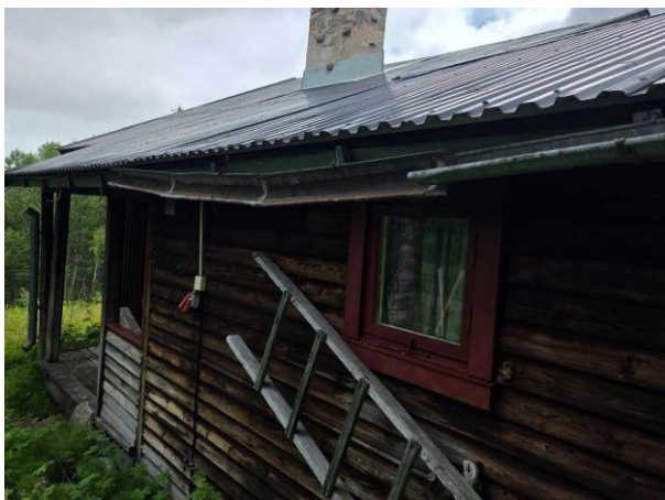
Bild 9: - Utvändigt, Avvattning, Dagvatten leds ej bort från grund. Hängrännor/stuprör saknas/skadad efter troligt snöras.
