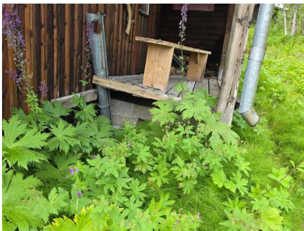
Bild 10: - Utvändigt, Avvattning, Dagvatten leds ej bort från grund. Hängrännor/stuprör saknas/skadad efter troligt snöras.
