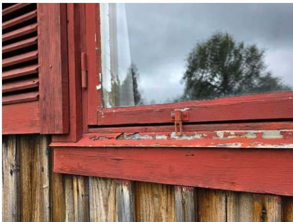
Bild 8: Utvändigt, Fönster, Kittskador och färgsläpp noterades på fasad.
