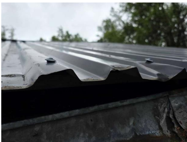
Bild 12: Utvändigt, Yttertak, Den tekniska livslängden på yttertaket har passerats och är i behov av byte/renovering.
