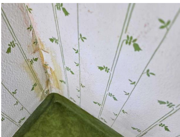
Bild 18: - Invändigt, Entréplan, äldre tät och ytskickt där den tekniska livslängden har passerats. Otäta rör genomföringar i våt...
