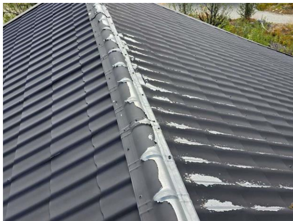
Bild 14: - Utvändigt, Yttertak, Färgsläp på takplåt. Otätt runt skorsten.
