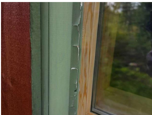
Bild 10: Utvändigt, Fönster, Torrsprickor och mindre kittskador.
