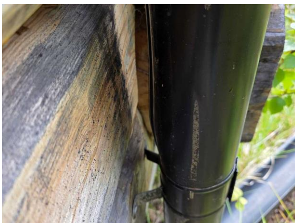
Bild 12: - Utvändigt, Avvattning, Frysprängningar på stuprör vid entré. Dagvatten leds ej bort från grund.
