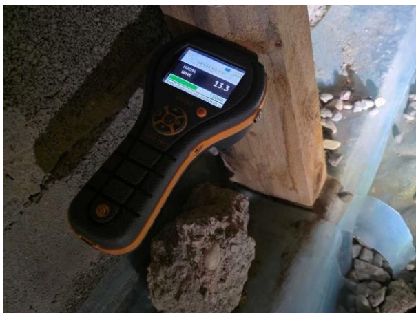
Bild 3: - Utvändigt, Grundmur/Hussockel, Äldre fuktmärken med påväxt i grund. Inga förhöjda fuktvärden uppmättes vid besiktningstillfället...
