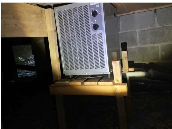
Bild 5: - Utvändigt, Grundmur/Hussockel, Äldre fuktmärken med påväxt i grund. Inga förhöjda fuktvärden uppmättes vid besiktningstillfället...
