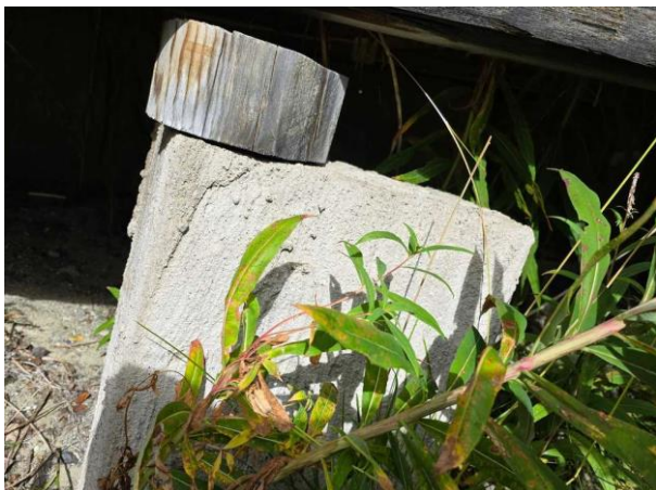
Bild 7: - Utvändigt, Grundmur/Hussockel, Äldre fuktmärken med påväxt i grund. Inga förhöjda fuktvärden uppmättes vid besiktningsstillfället...
