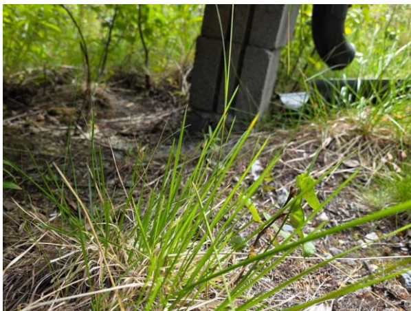
Bild 8: - Utvändigt, Grundmur/Hussockel, Äldre fuktmärken med påväxt i grund. Inga förhöjda fuktvärden uppmättes vid besiktningsstillfället...
