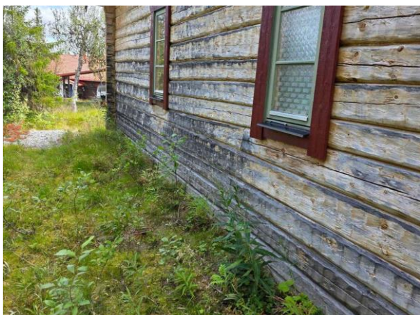
Bild 9: Utvändigt, Fasad, Fasad flammig
