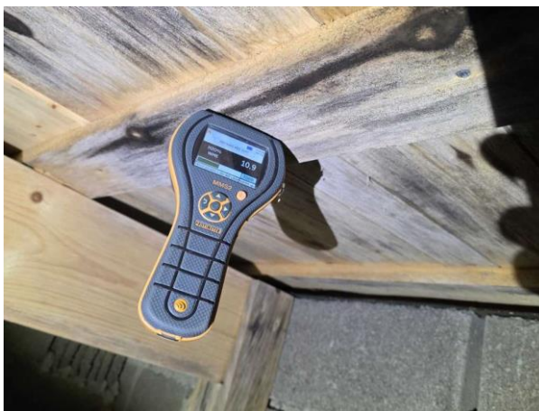
Bild 4: - Utvändigt, Grundmur/Hussockel, Äldre fuktmärken med påväxt i grund. Inga förhöjda fuktvärden uppmättes vid besiktningstillfället...
