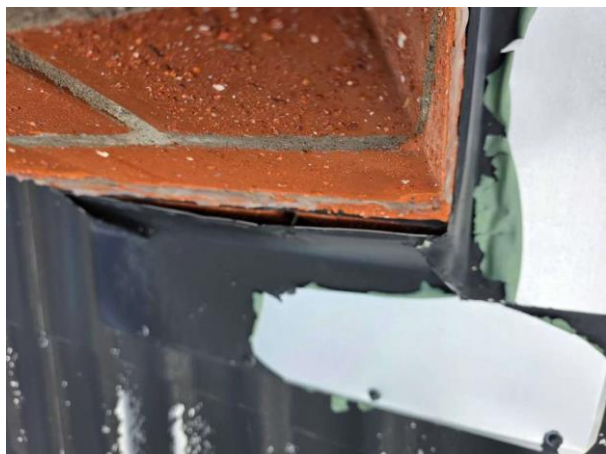
Bild 15: - Utvändigt, Yttertak, Färgsläp på takplåt. Otätt runt skorsten.
