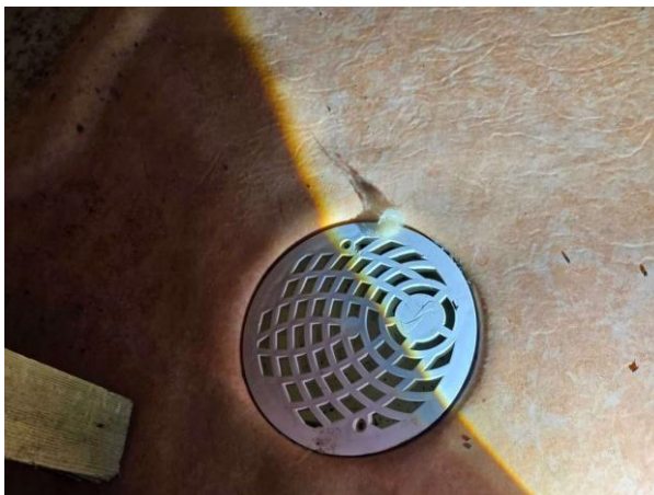
Bild 20: - Bastu, Avvikande lukt. Matta släppt på golv.
