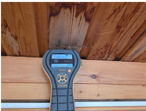
Bild 16: - Kök, Fuktmärken i tak över köksskåp. (Inga förhöjda fuktvärden uppmättes vid besiktningstillfället.)
