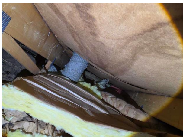
Bild 11: - Vind, Fuktmärken vid takgenomföringar. Fuktmärken med påväxt på undertak och takstolar.
