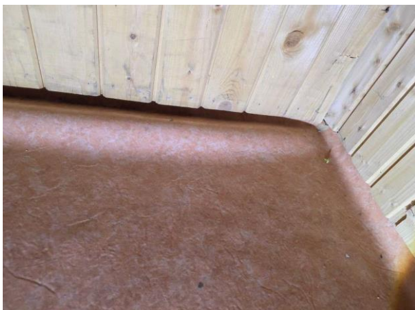
Bild 17: - Bastu, Avvikande lukt. Matta släppt på golv.
