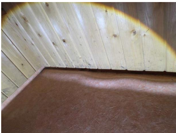
Bild 18: - Bastu, Avvikande lukt. Matta släppt på golv.
