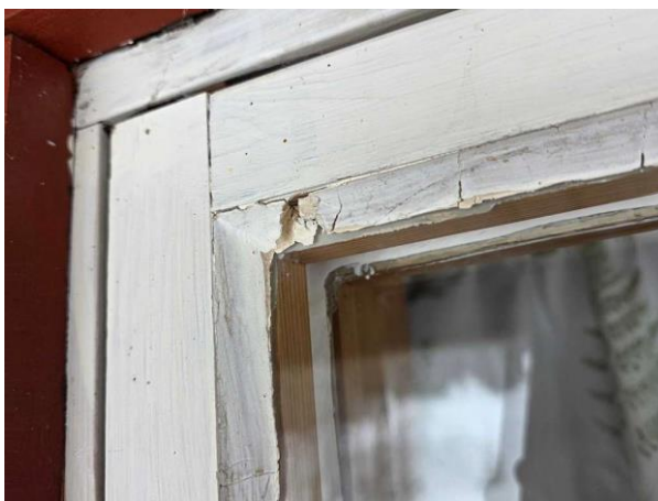
Bild 10: Utvändigt, Fönster, Kittskador och torrspäckor noterades på fönster.
