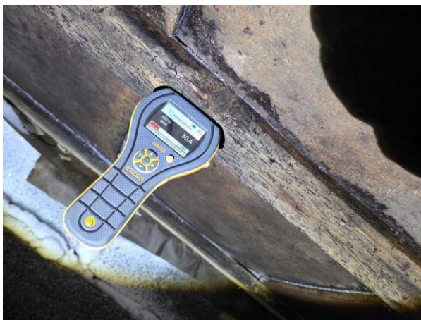
Bild 4: - Grundmur/Hussockel, Kraftig påväxt på trossbotten. Fuktskada Uppmätta fuktvärden 30-54%
