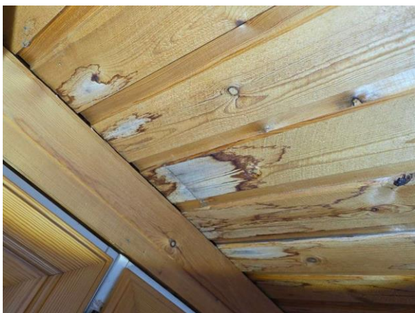
Bild 15: - Kök, Fuktmärken i tak över köksskåp. (Inga förhöjda fuktvärden uppmättes vid besiktningstillfället.)
