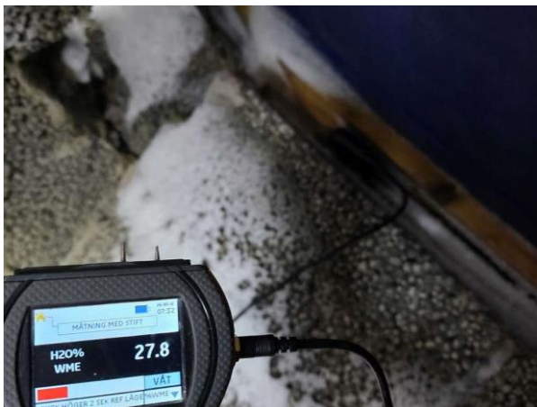
Bild 2: - Grundmur/Hussockel, Fel materialval av trossbotten.
