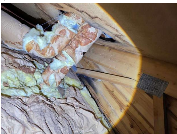
Bild 12: - Vind, Fuktmärken vid takgenomföringar. Fuktmärken med påväxt på undertak och takstolar.
