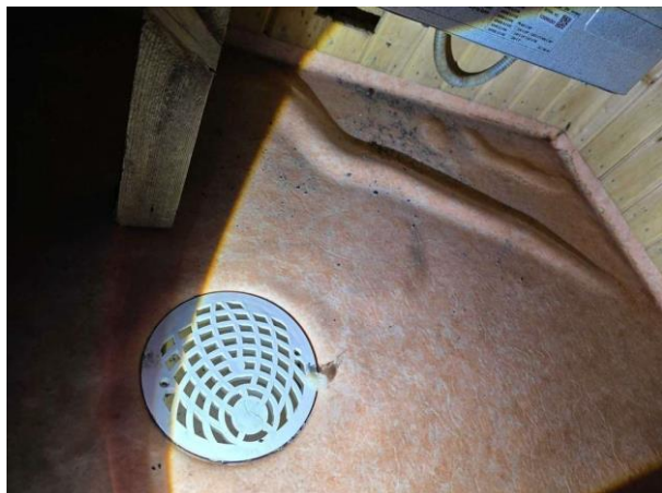
Bild 19: - Bastu, Avvikande lukt. Matta släppt på golv.
