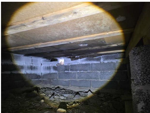
Bild 3: - Grundmur/Hussockel, Kraftig påväxt på trossbotten. Fuktskada Uppmätta fuktvärden 30-54%
